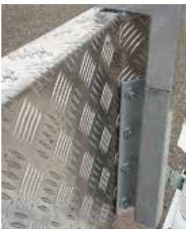
No. art. Alaskan PL 4.03 Lamiera striata, oltre il bordo del ponte di fabbrica
